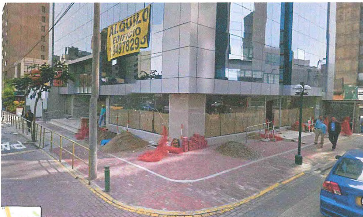
Foto: Retiro ocupado por voladizo sobre Av. Diez Canseco y Av. La Paz.
